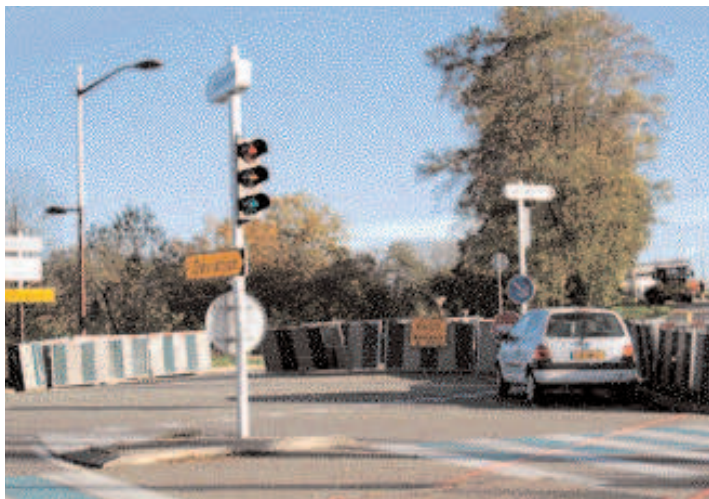
La fermeture du pont d'Ostwald marque le début des travaux d'aménagement du tram
