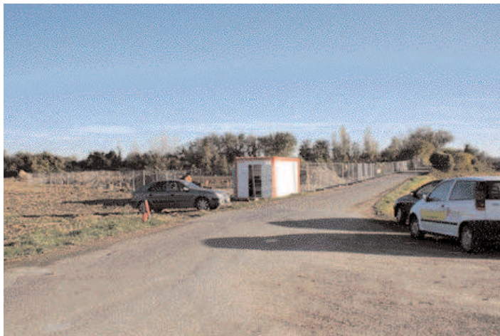
Les travaux du terrain des gens du voyage d'Ostwald - Lingolsheim viennent de commencer
